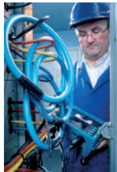
Messung der der Versorgungsqualität mit ANALYST 3Q und flexiblen LEM-Flex Stromsensoren
