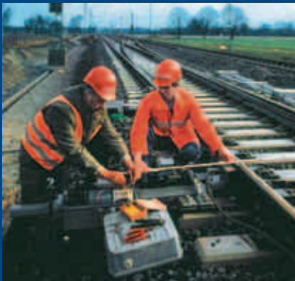
Vorausschauende Instandhaltung von Weichen durch Strommessung führt zu höherer Sicherheit
